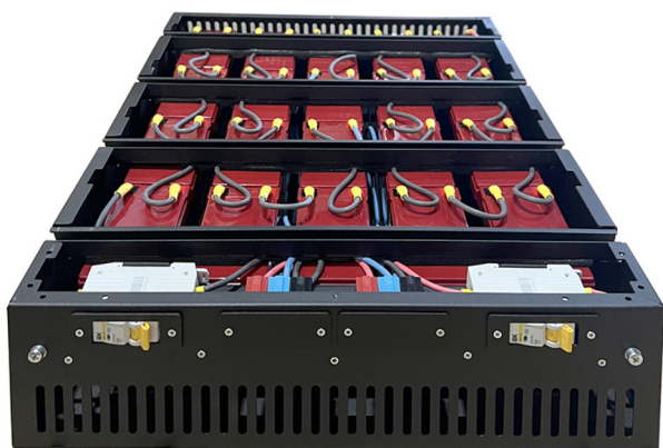
Размещение аккумуляторных батарей
